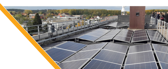
Panneaux solaires Béthune
