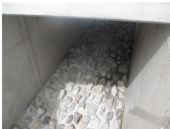
Figure 34 : Exemple de bloc enchâssés dans un radier béton (passe à poissons du décours, chantier sous maîtrise d'œuvre ARTELIA, 2015)
