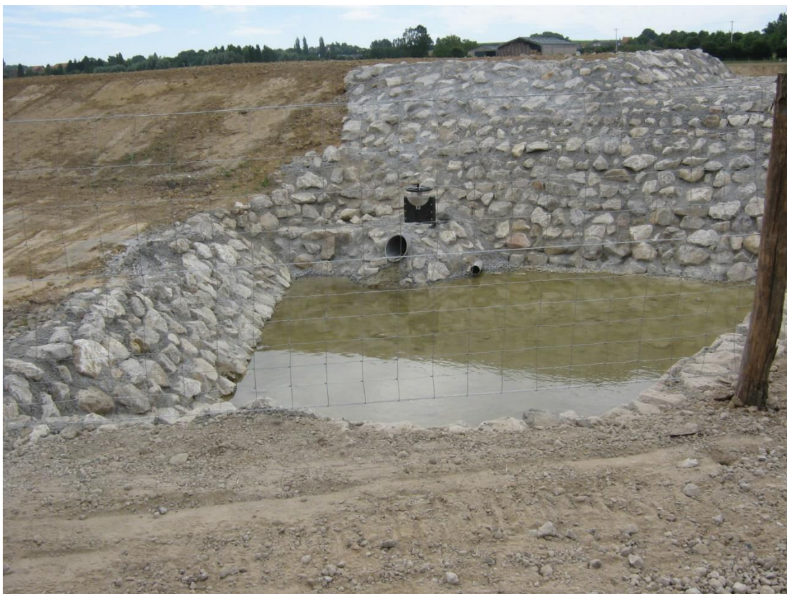
Figure 35 : Exemple de création de surverse de sécurité constitué en enrochements bétonnés (Source : Communauté d'Agglomération de Béthune-Bruay, Artois Lys Romane)
