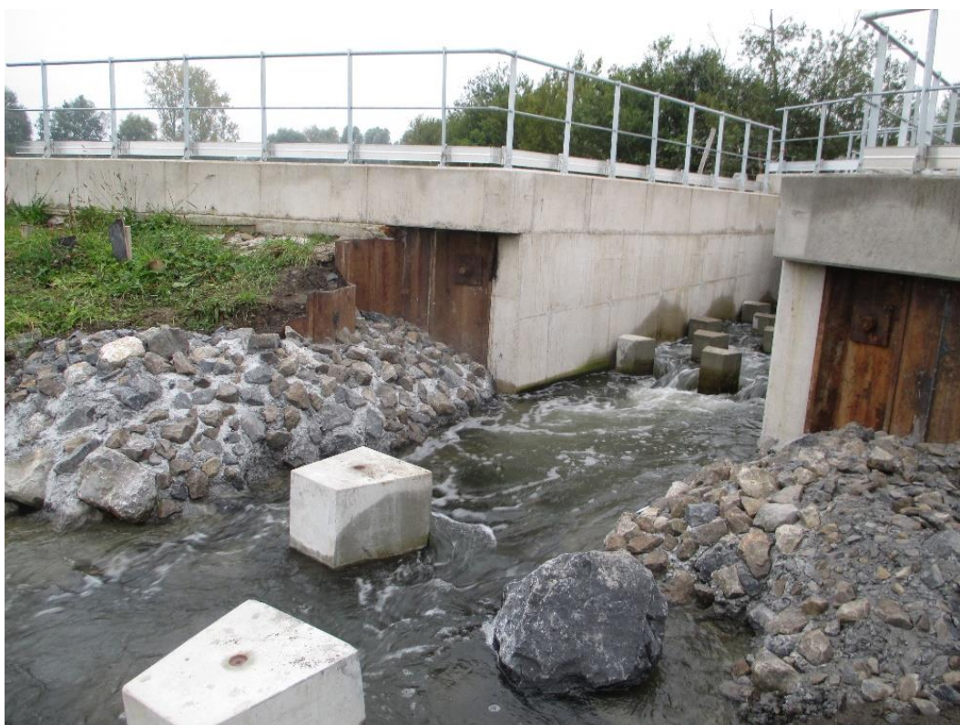
Figure 37 : Exemple de consolidation de berges constitué d'engrochements liés au béton (Source : ARTELIA)
