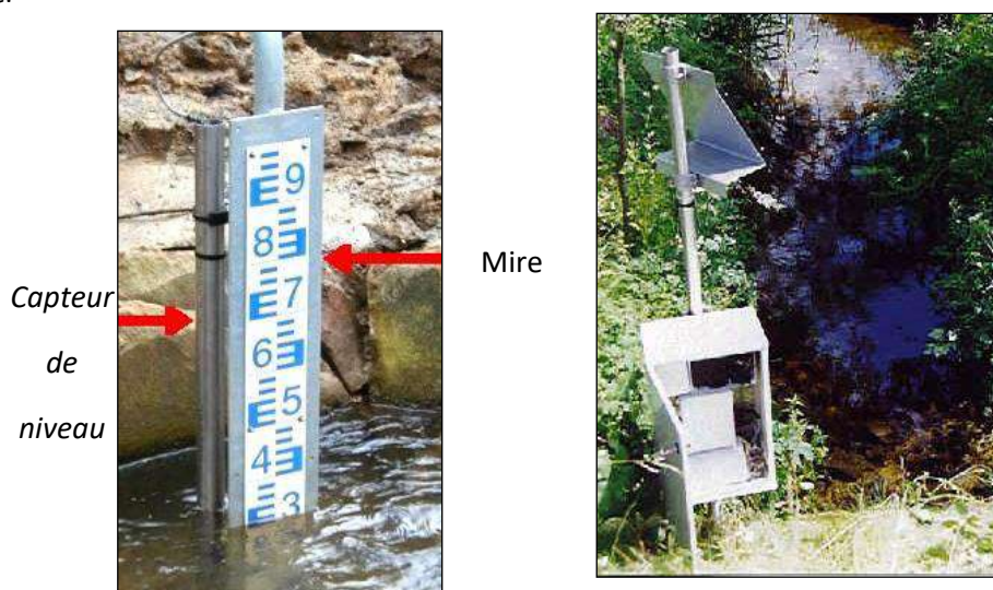
Figure 55 : Exemple de capteur associé à une mire – Exemple de centrale d'acquisition
