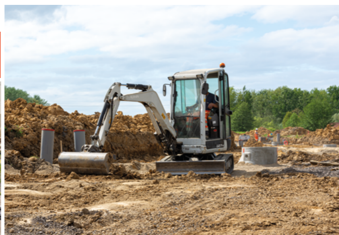
↑ 25 mai 2022 ZAC Chemin de l'Abbaye • Démarrage de la première phase de viabilisation
